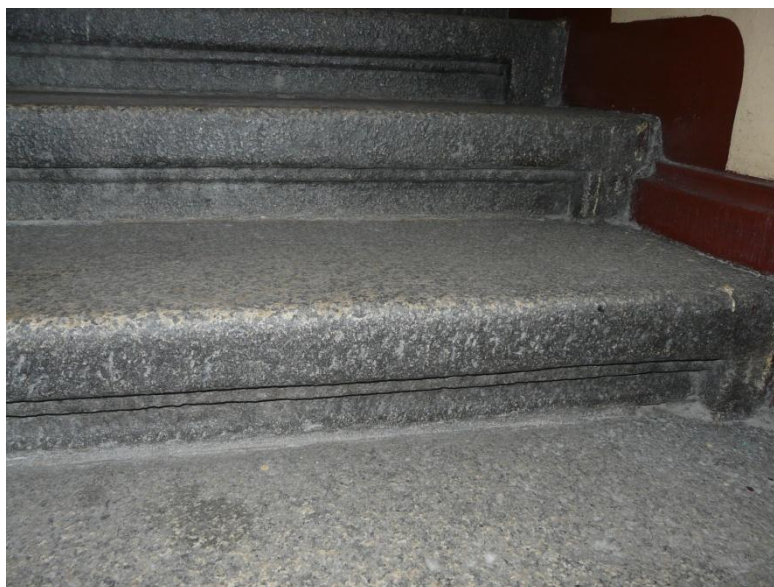
Fot.2. Zabrudzona powierzchnia stopni granitowych.
