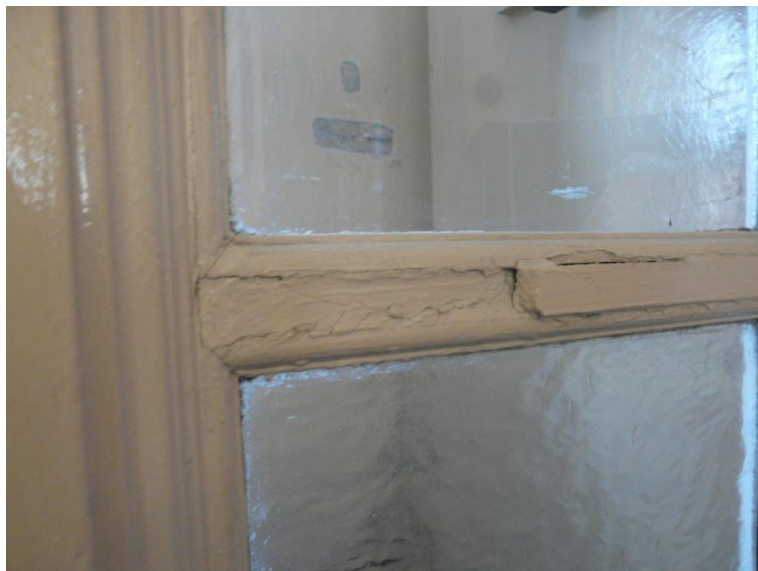
Fot. 12. Ubytek w szczelinie wiatrołapu
