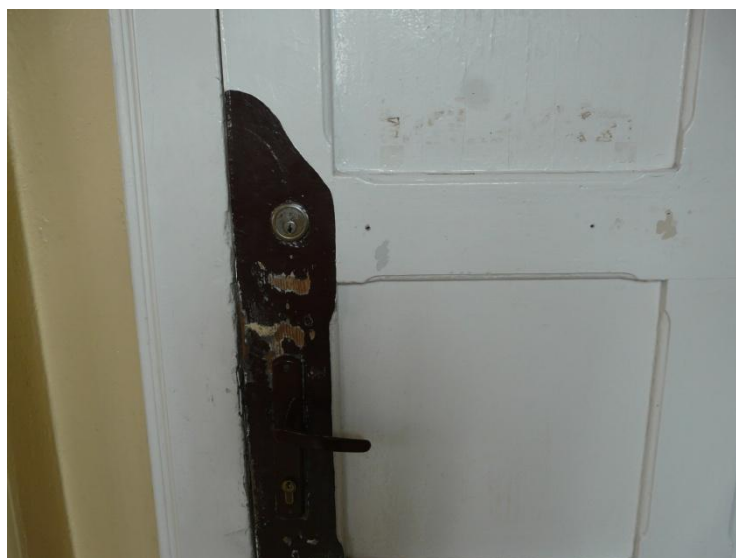
Fot. 11. Drzwi do jednej z sal. Widoczne odspajające się warstwy przemalowań.
