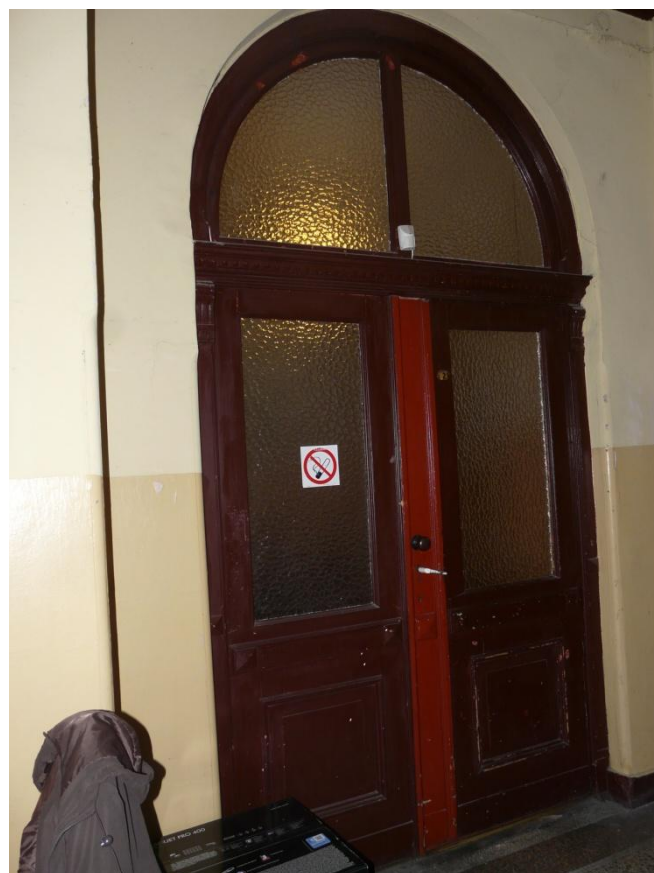
Fot. 20. Drzwi na korytarz z łuszczącą się farbą.
