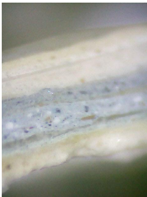
Stratygrafia warstw ściany nad lamperią
