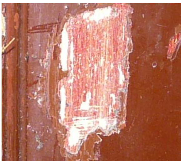
Odkrywka na drzwiach między sienią a korytarzem- od strony sieni.
