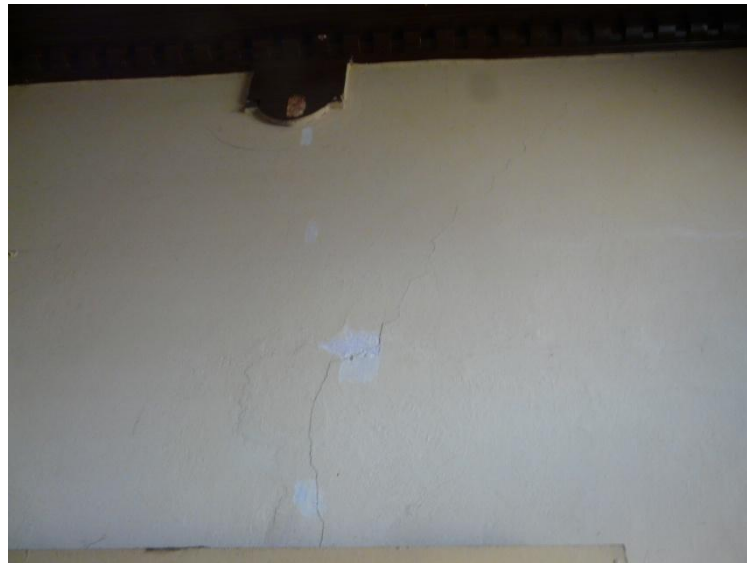
Fot. 18. Spękanie ściany, odspojenie farby.
