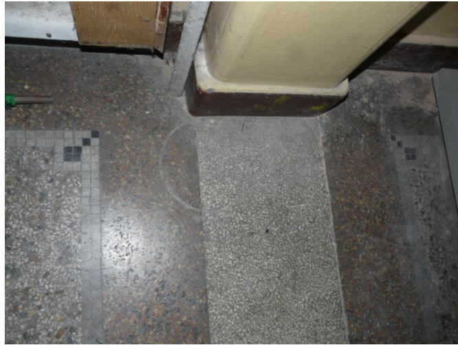
Fot. 21. Fragment posadzki w sieni. Zabrudzona, porysowana powierzchnia.
