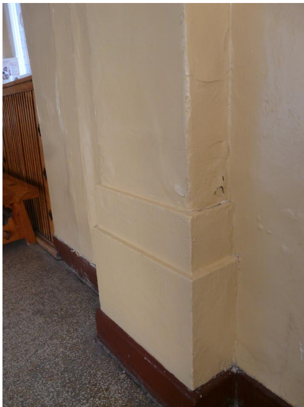
Fot. 3. Spęcherzony, odspajający się tynk.
