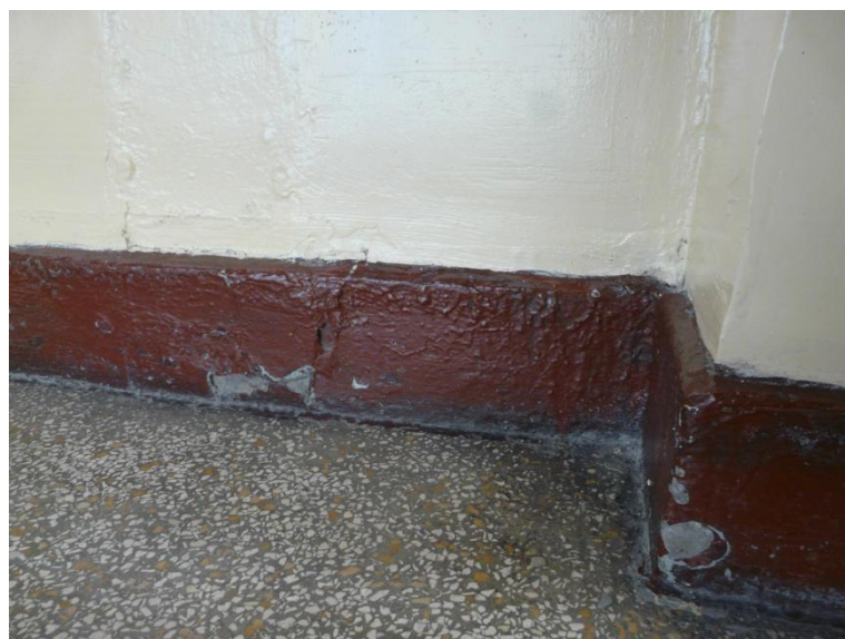
Fot. 10. Ubytki w cokole pokrytym warstwami przemalowań.
