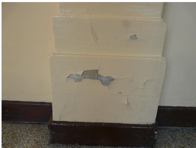
Fot. 8. Spękane, odspajające się warstwy malarskie
