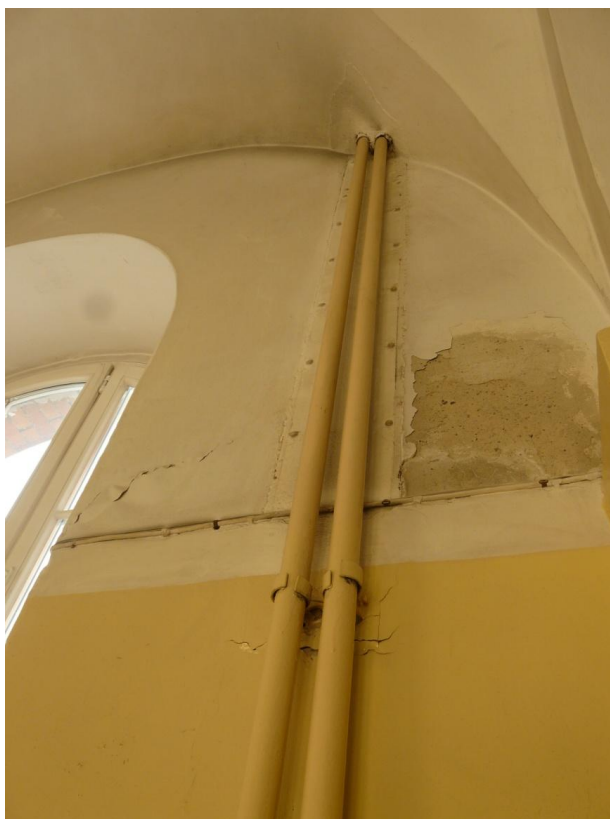
Fot. 7. Odspojony tynk, łuszczące się warstwy farby, zabrudzony sufit.
