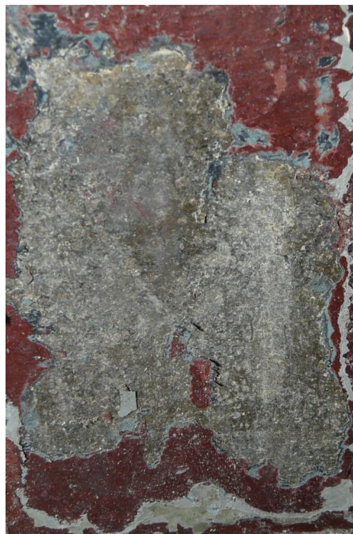
Odkrywka na cokolicu.
