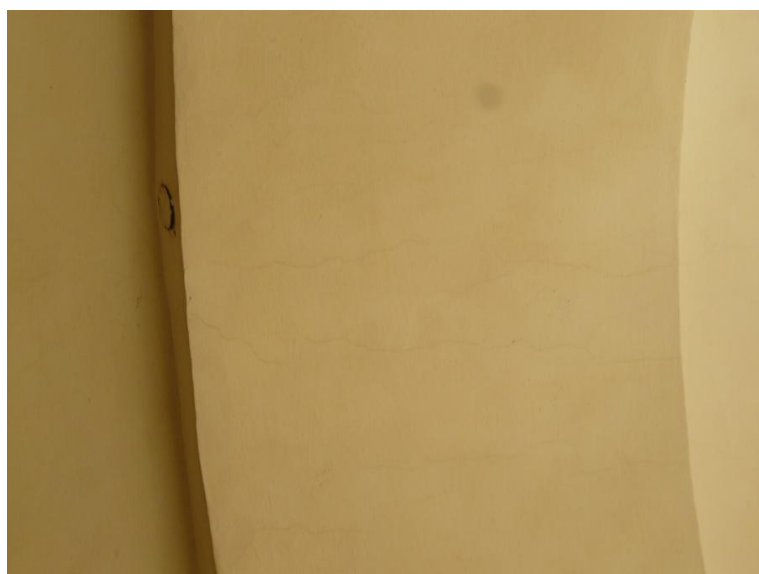
Fot. 5. Spękania na suficie.
