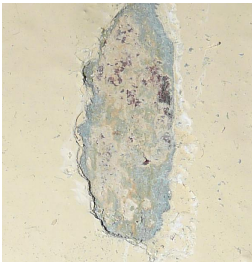
Odkrywka na metalowym kształtowniku na ścianie korytarza
