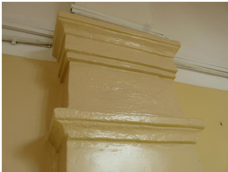
Fot. 9. Nieestetyczne uzupełnienia i reprofilacje gzymsów.
