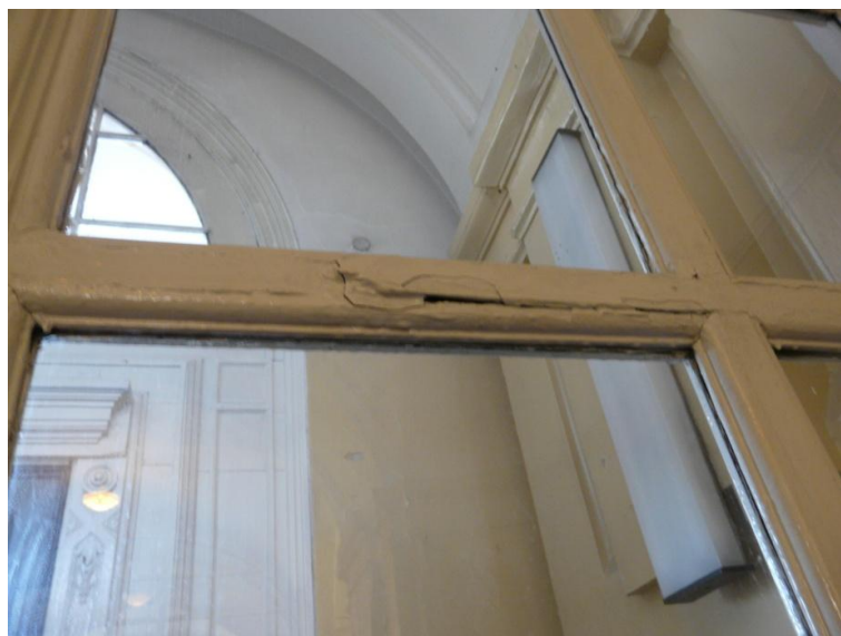
Fot. 13. Spękanie szczeliny wiatrołapu.
