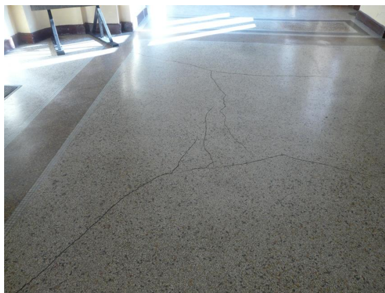
Fot. 14. Spękanie posadzki z lastriko.
