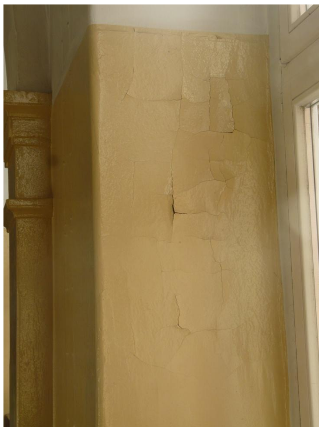
Fot. 6. Spękane, odspajające się warstwy farb.
