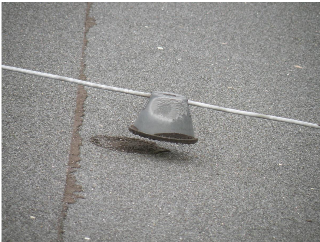
Fot. 11. Odspojona podpórka instalacji odgromowej
