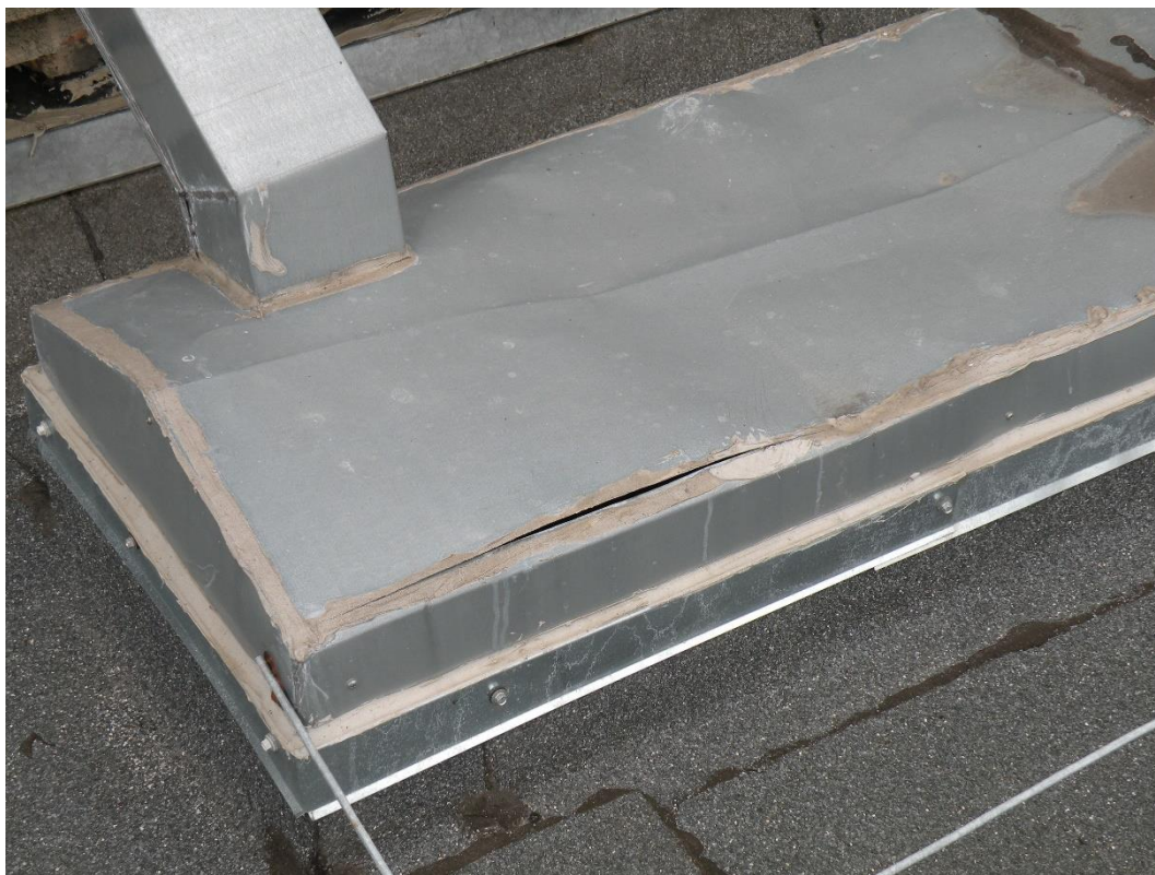
Fot. 13. Uszkodzenie obróbki blacharskiej
