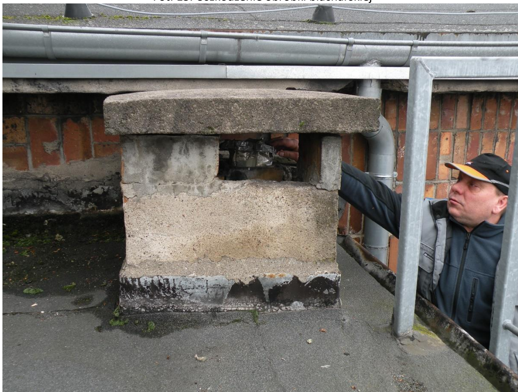
Fot. 14. Uszkodzona nakrywa kominowa
