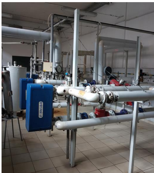
Rys. 8. Widok na pomieszczenie węzła cieplnego
