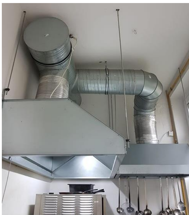
Rys. 11. Wyciąg z kuchni przemysłowej
