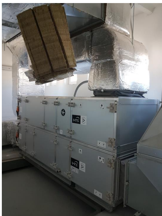
Rys. 10. Widok centrali wentylacyjnej obsługującej czytelnice wydziałową
